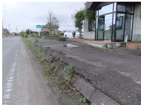
II-6. 隆起したマンホール
