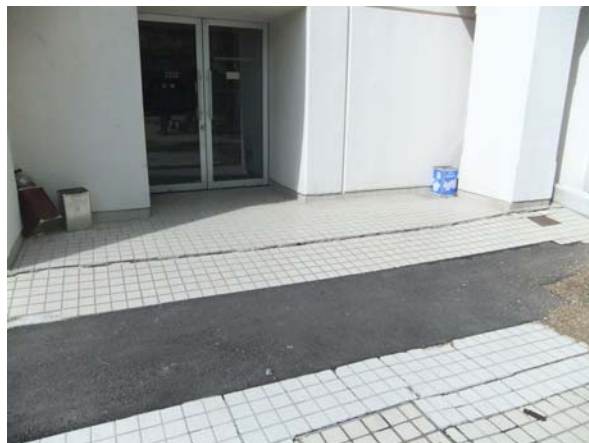
I-3. 市役所通用口付近の地盤沈下
