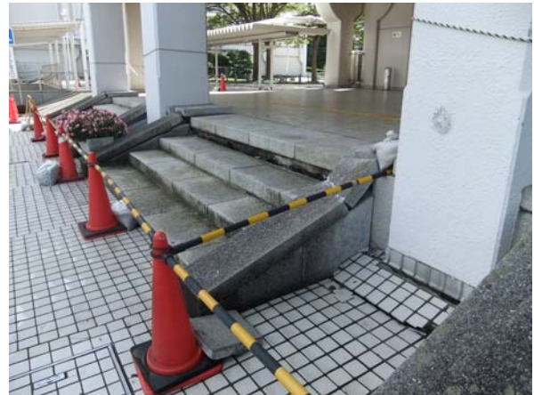
I-2. 市役所玄関の地盤沈下
