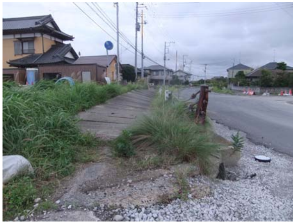
II-1. 液状化による歩道の隆起
